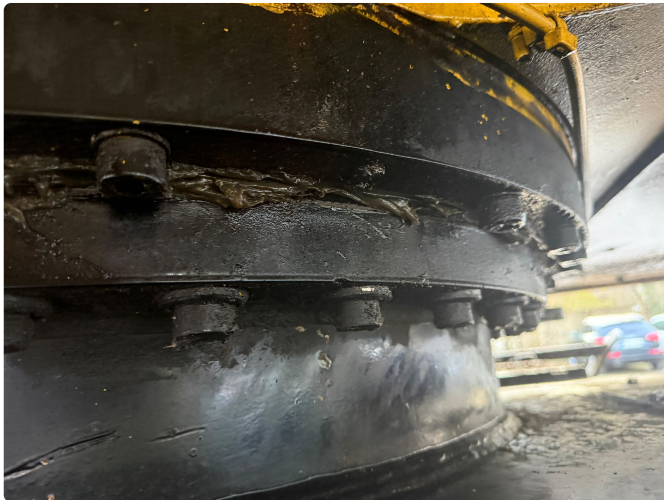
Abgerissene Schrauben zwischen Ober.- und Unterwagen
